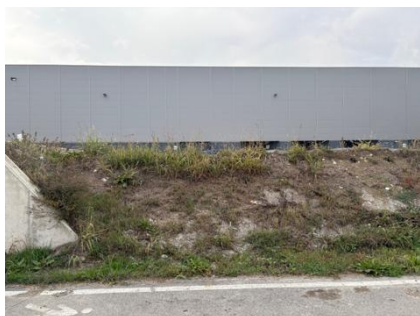
Opere compensative e aree verdi di cessione in stato di degrado e assenza di manutenzione
