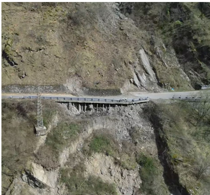
Val d'Aveto: frana Diga di Boschi
