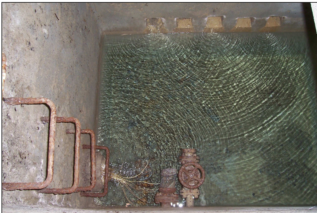
Fig. 1.22 - Sorgente Badoni 1-2 (Bettola) vista dall'interno e dall'esterno: la presa (vasca di raccolta interna) risiede presso la sorgente Badoni 2 e raccoglie le acque provenienti dalla Badoni 1 e 2.
